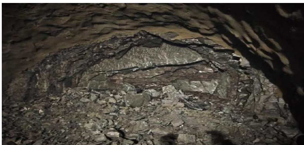
Slika 5. Izbijanje stijenskih blokova u tunel Zenica
