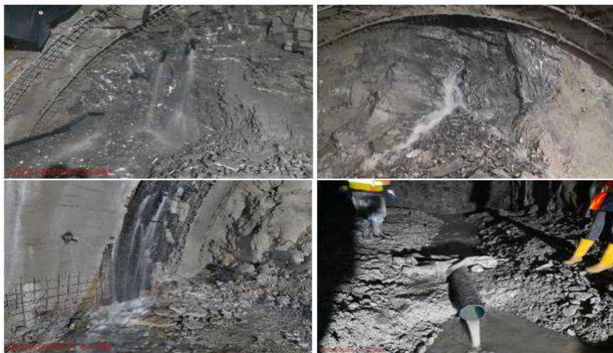
Slika 2. Pojava podzemne vode tunel Zenica
