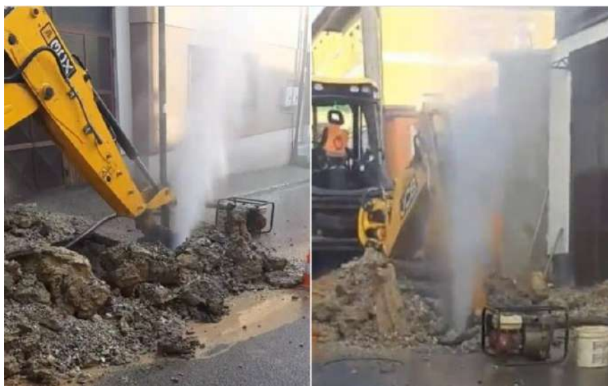
Slika 5. Oštećena cijev gasne mreže (Izvor: https://www.faktor.ba )
