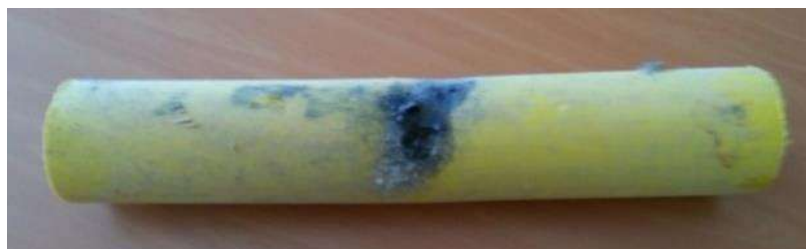
Slika 4. Oštećena cijev gasne mreže
