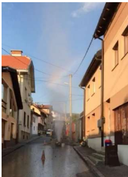
Slika 6. Oštećena cijev gasne mreže u naselju Bjelave
