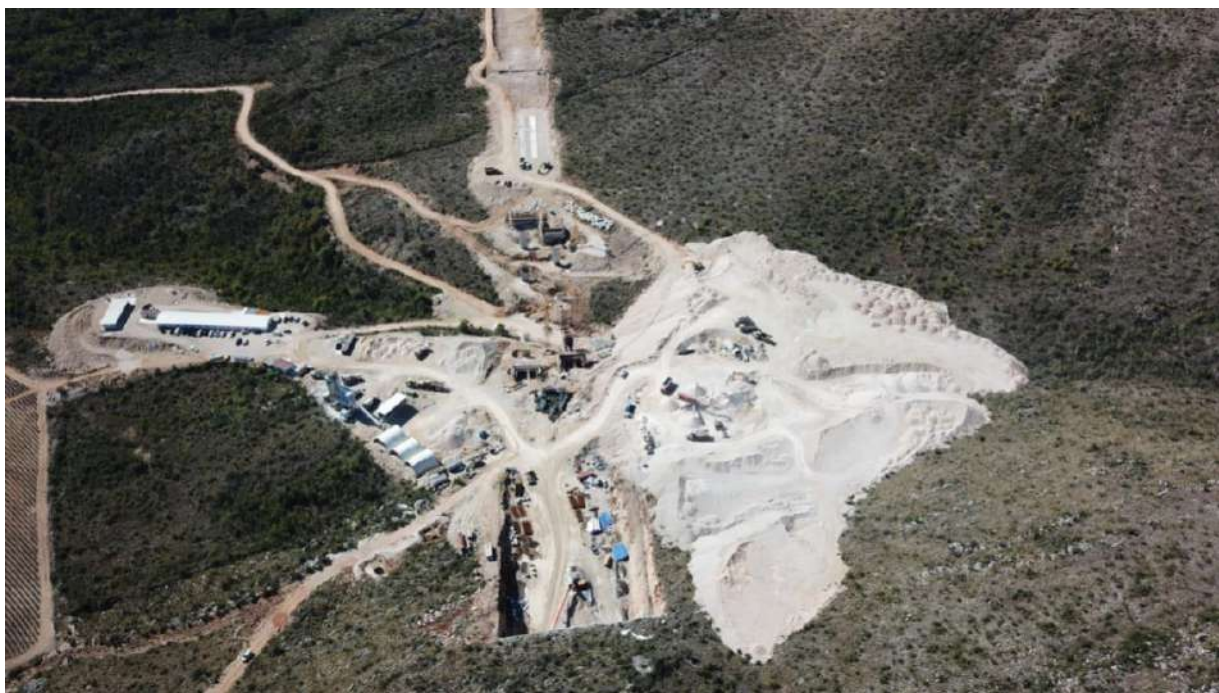
Slika 1. Prostorni položaj deponije iskopatog materijala i njegovog recikliranja u odnosu na ulaz u tunel [6]
