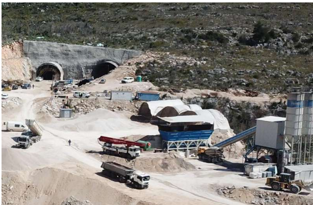
Slika 4. Izgled instalirane betonare za proizvodnju betona [6]
